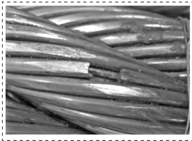
Рис. 1. Поврежденный участок каната с пластически обжатыми прядями
