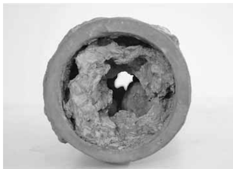
Рис. 1. Фрагмент отложений на внутренних стенках чугунных труб
